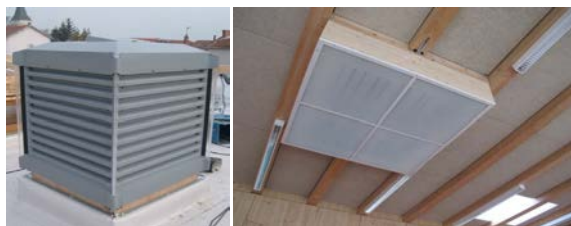
Exemple de dispositif de ventilation naturelle École Primaire Vancia, à Rillieux la Pape (69) - à gauche : Tourelle en toiture - à droite : Grille de diffusion/extraction d'air © Crédit photos : Bureau d'étude TRIBU
