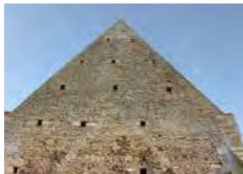
TROUS DE BOULINS SUR LA FAÇADE
