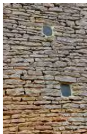
TROUS DE BOULINS OBSTRUÉS PAR LA POSE D'UNE ARDOISE
